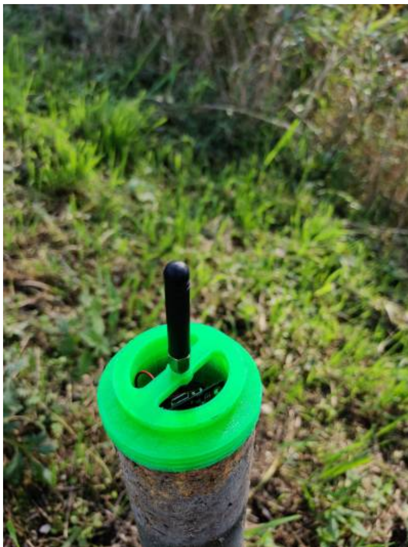
Fig. 4: Sensor und LoRa-Sender im Rohr installiert
