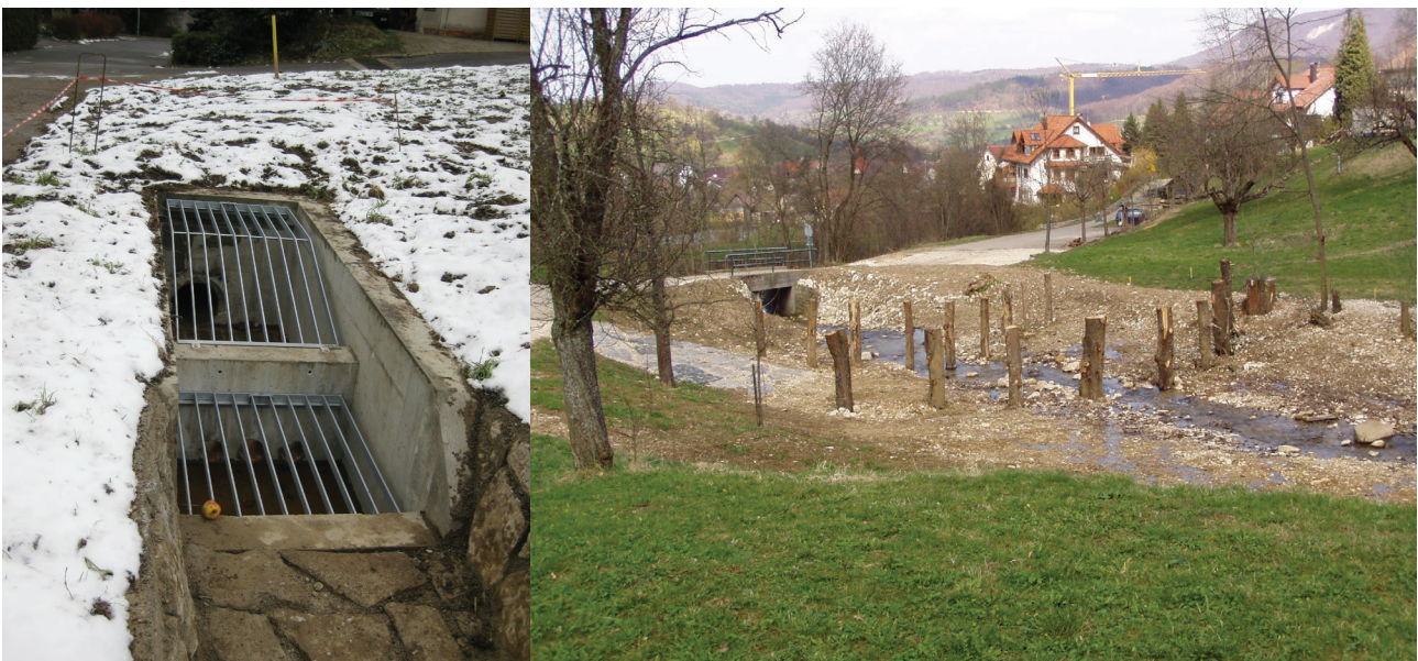
Abbildung 20: Links – Beispiel eines räumlichen Rechens, der eine Verstopfung durch Geschwemmsel und Treibgut erschwert (Wittmann, Stadt Buchen), Rechts – Verlegungsschutz mit Furt vor einem Straßendurchlass (Landratsamt Esslingen).
